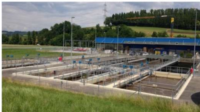
Рис. 3: Очистные сооружения «Оберес Сурбтал». Биологическая часть установки состоит из трех идентичных линий очистки.
