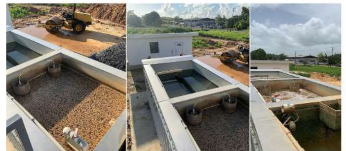
Рис. 5: Контейнерная станция очистки сточных вод, работающая на Mutag BioChip, в Тринидаде, 2019 г.
